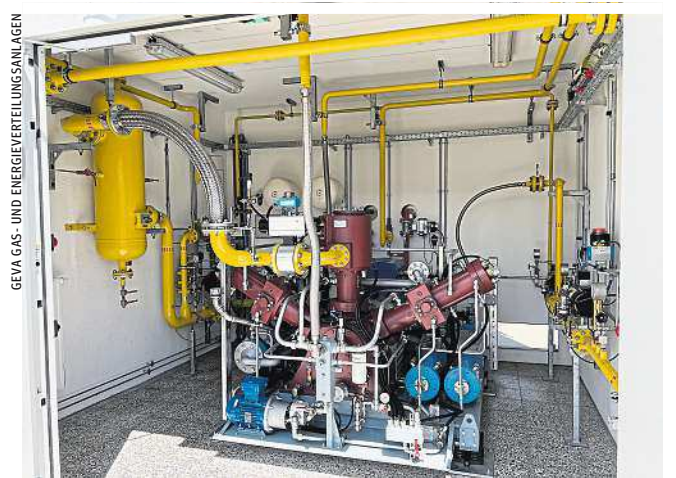
Verdichteranlage einer Biogasanlage
